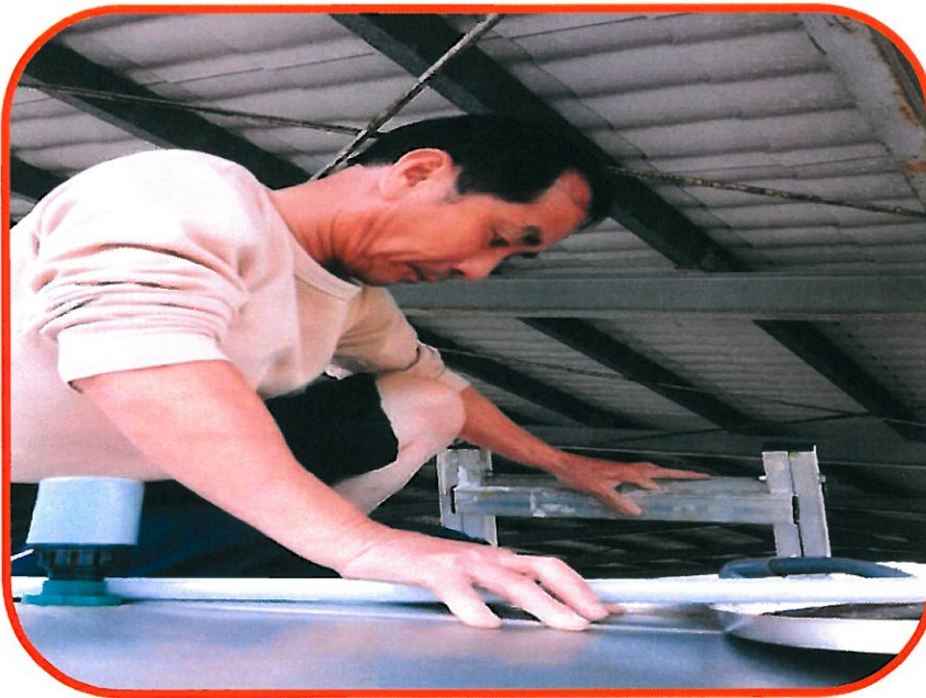
相片說明： 合格廠商定期清洗水塔
